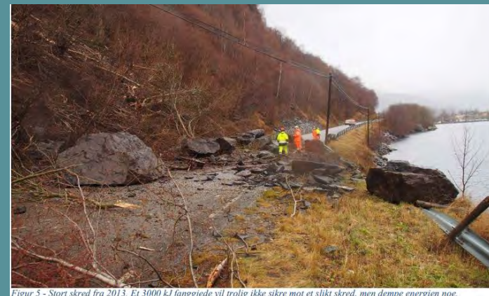
Figur 3 - Stort skred fra 2013. Et 3000 kJ fanggjede vil trolig ikke sikre mot et slikt skred, men dempe energien noe.
